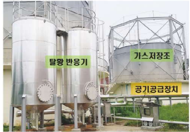
진주하수처리장 바이오가스 시설 예
